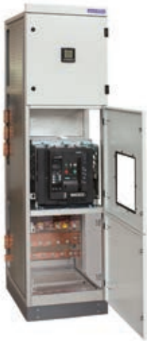
Leistungsschalter- und Kuppelfelder
