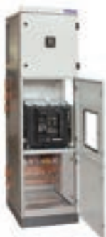
Leistungsschalter- und Kuppelfelder
